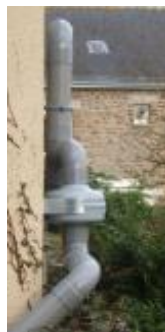
Ventilateur à l'extérieur
