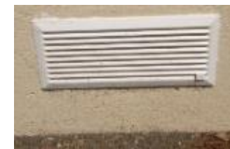
Entrée d'air du VS agrandie
