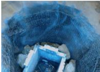
Trou dans le béton
