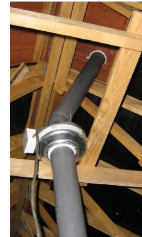
Extracteur dans les combles
