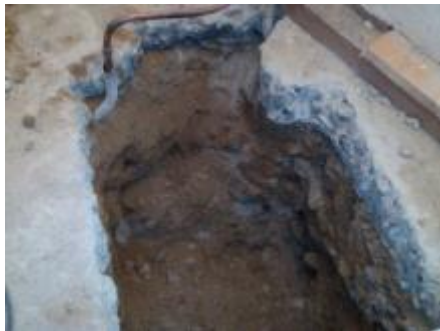
Trou dans le béton
