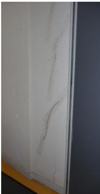
Rubans adhésifs sur fissures
